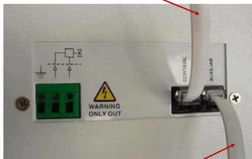
Podłączenie kolejnej kurtyny
